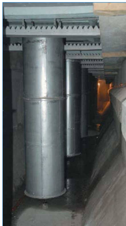
■ Рис. 5. Рабочая зона осветлителя после реконструкции на Чусовских очистных сооружениях г. Перми
